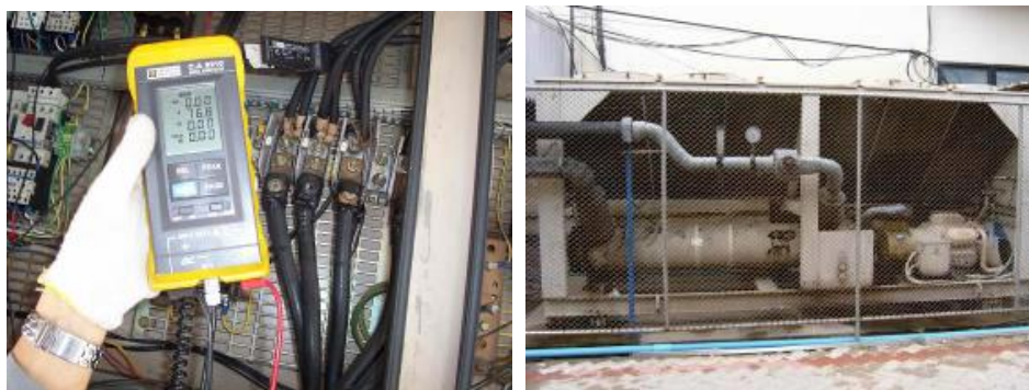
ภาพเครื่องทำน้ำเย็นสำหรับปรับอากาศและการตรวจวัดค่ากระแสไฟฟ้า
