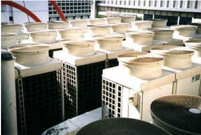
ตำแหน่ง CDU. ของโรงแรม อยู่บริเวณดาดฟ้าชั้นที่ 12 จะสังเกตเห็นว่า สามารถวางเครื่อง อยู่ใกล้กันมาก เนื่องจากเป็นระบบลมร้อนพัดขึ้นด้านบน
