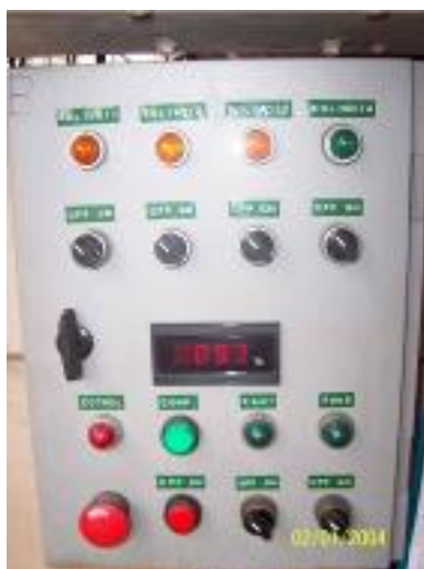
ภาพการตั้งอุณหภูมิน้ำเย็นและการเดิน Comp. และ ปั้มน้ำเย็นอย่างละเอียด
