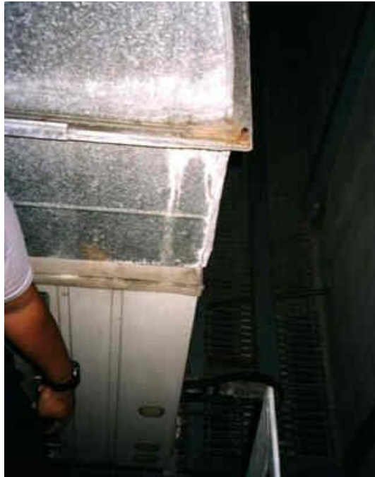
ที่ตั้งของเครื่อง CDU บริเวณมุมอาคาร อุปกรณ์ วางอยู่บนพื้นตระแกรงเหล็ก
