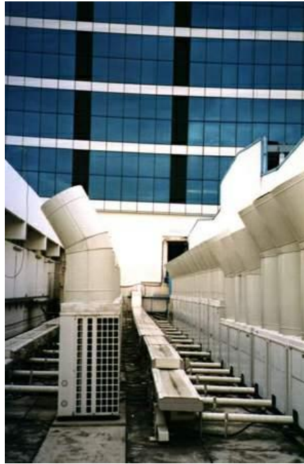
ตำแหน่งที่ตั้งของ CDU บริเวณดาดฟ้าชั้น 2 ของอาคารได้มีการแบ่งกลุ่มของ CDU เป็นกลุ่ม แต่ละกลุ่มจะจ่ายน้ำยาปรับอากาศให้แก่ FCU ของอาคารแต่ละชั้น
