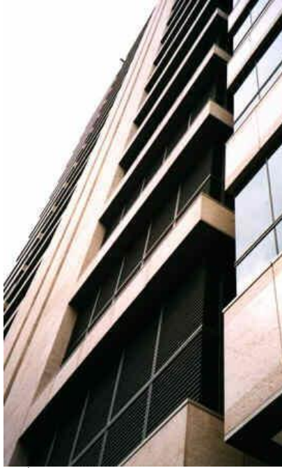
ผนัง ด้านข้างของอาคารส่วนหนึ่ง เป็นเกล็ดดอลุมิเนียมระบายอากาศ เป็นบริเวณที่ใช้ตั้งเครื่อง CDU โดยกระจายอยู่ใน ทุกชั้น ของอาคาร
