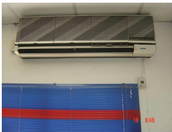
เครื่องปรับอากาศที่ใช้ในสำนักงาน
