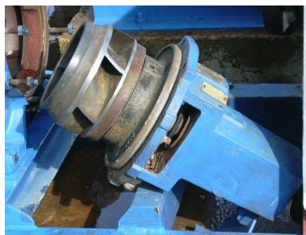
รูปแสดงปั๊มน้ำหลังการปรับปรุง
