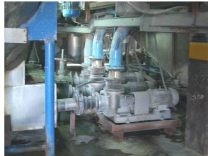
ภาพก่อนปรับปรุงของมอเตอร์ปั๊มน้ำกากของเสี้ยน
