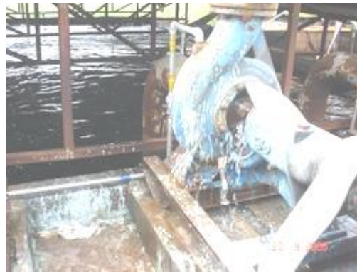
ก่อนปรับปรุงมีการรั่วไหลของน้ำ
